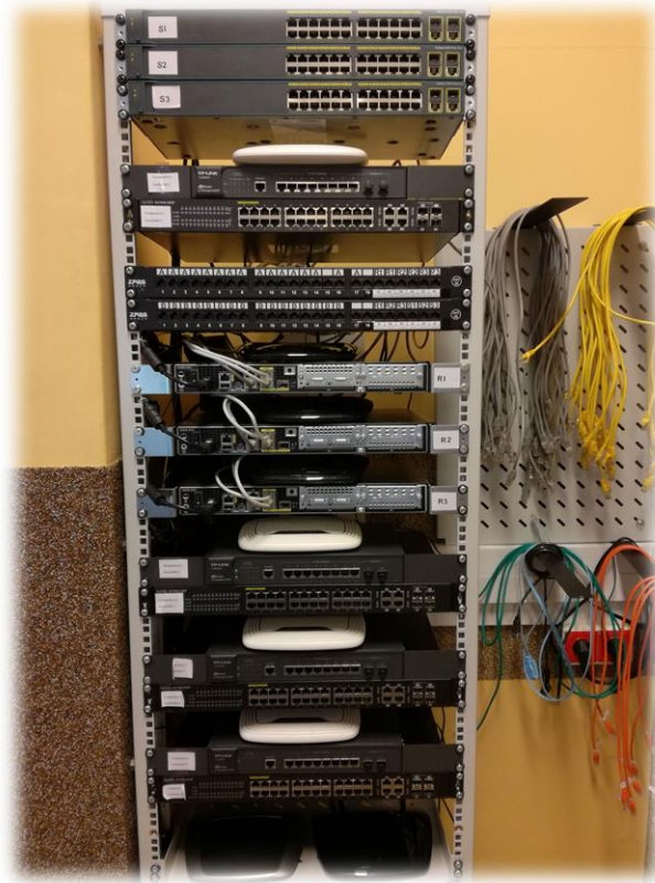
Szafa w Laboratorium Sieci Komputerowych
